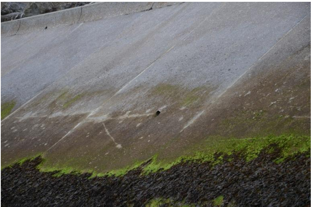
Des fissures sont visibles sur le parement du perré.
