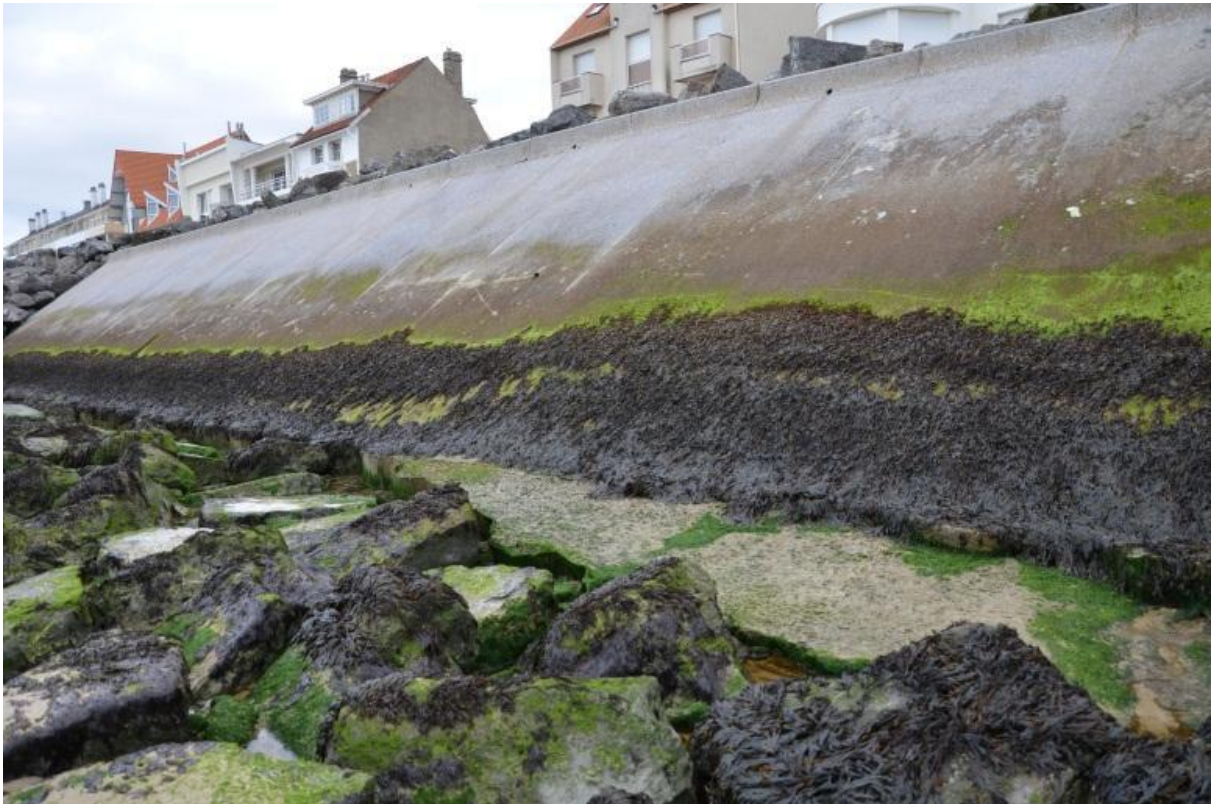
Zone de rupture des palplanches de pied suite à la tempête de janvier 2007, comblée à l'aide de béton
